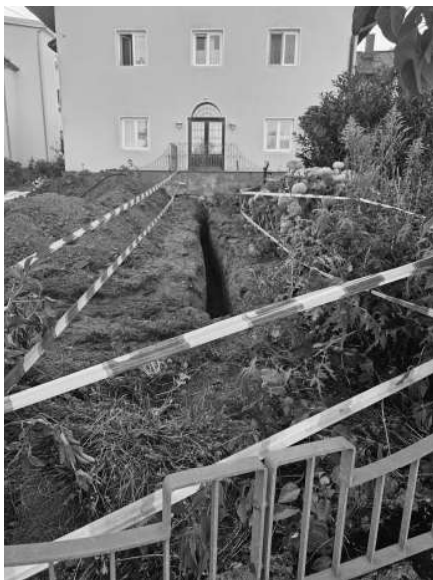
Wasserleitung musste erneuert werden.
