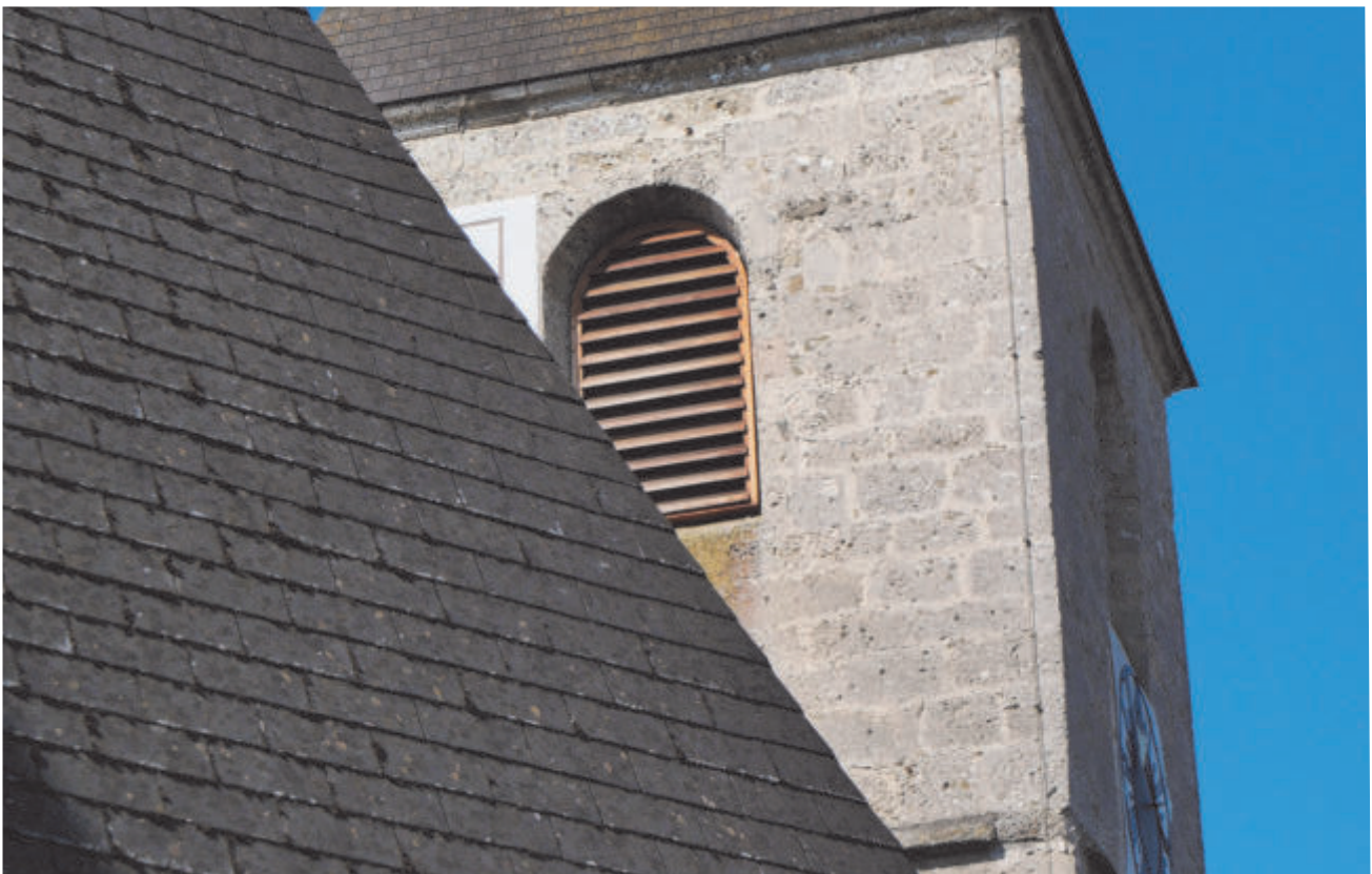
Turm, Ostfassade, biogener Bewuchs unter der Schallöffnung
