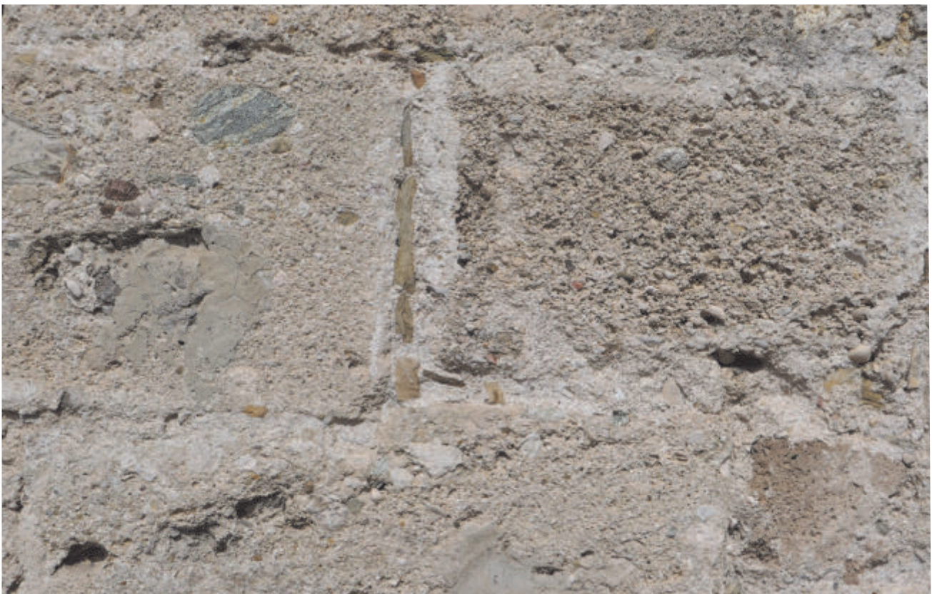
Turm, Südfassade, Fugen mit Kalkmörtel und Zwickelsteinen gemauert, Mörtel rückgewittert
