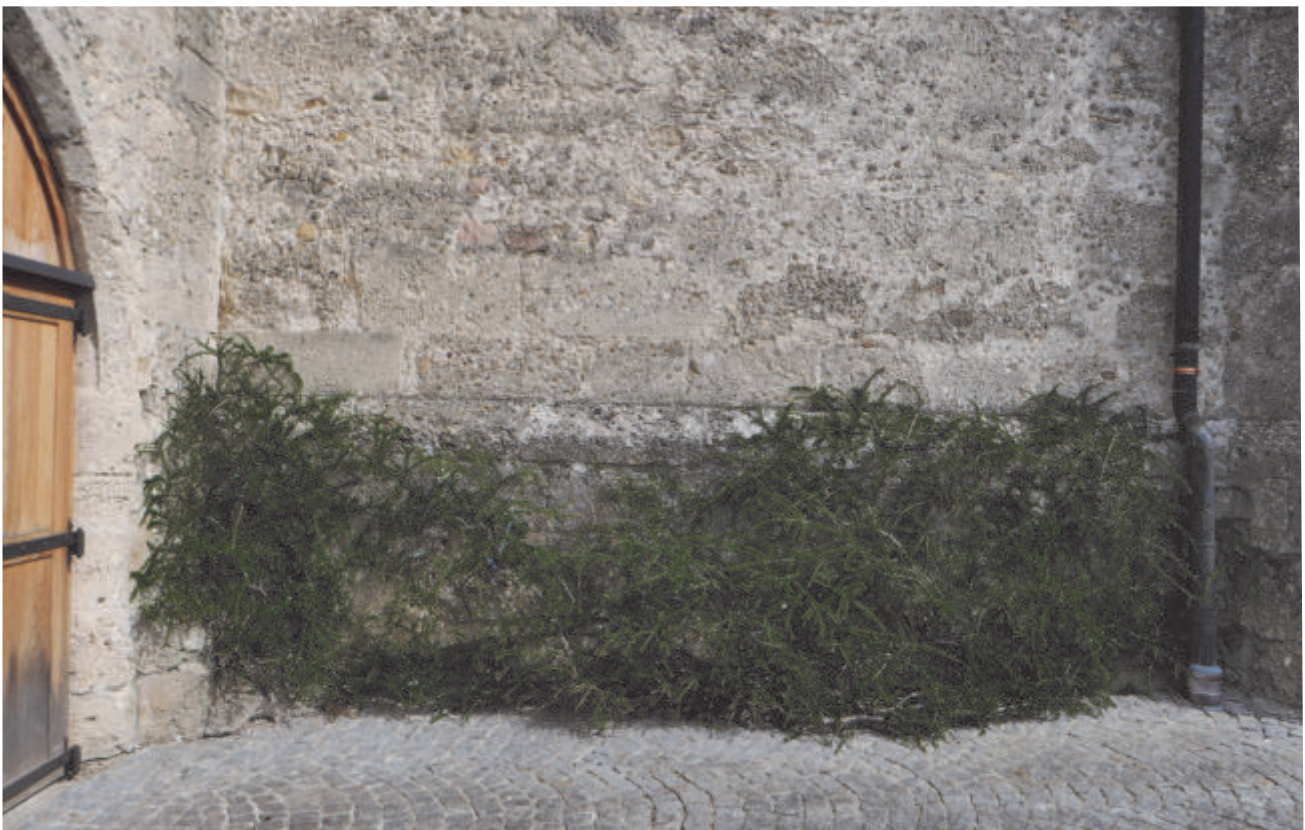
Langhaus, West, rechte Fläche, Anschluss zum Turm und Strebepfeiler, verwachsener Sockel
