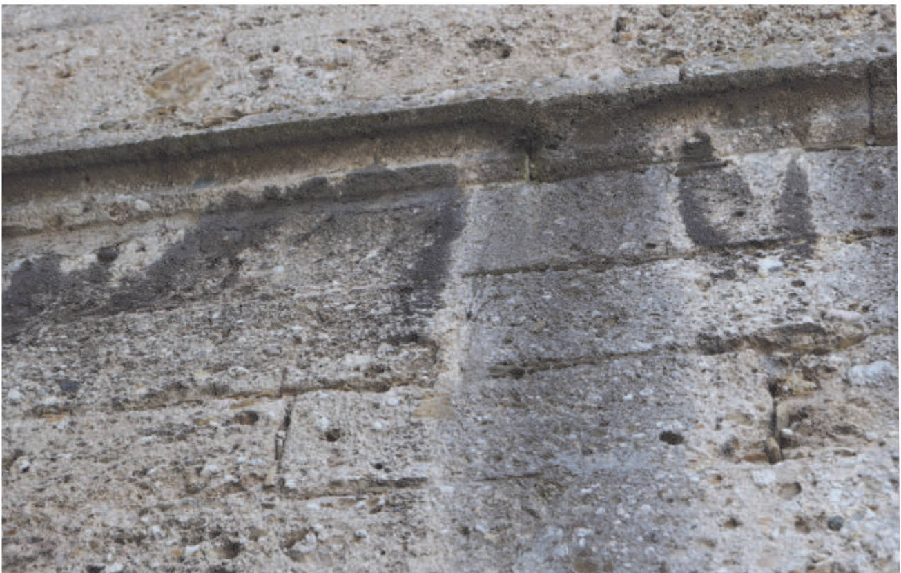
Turm, Nordfassade, Erdgeschoß, allgemein verschmutzt, Gipsfahnen, rückgewitterte Fugen
