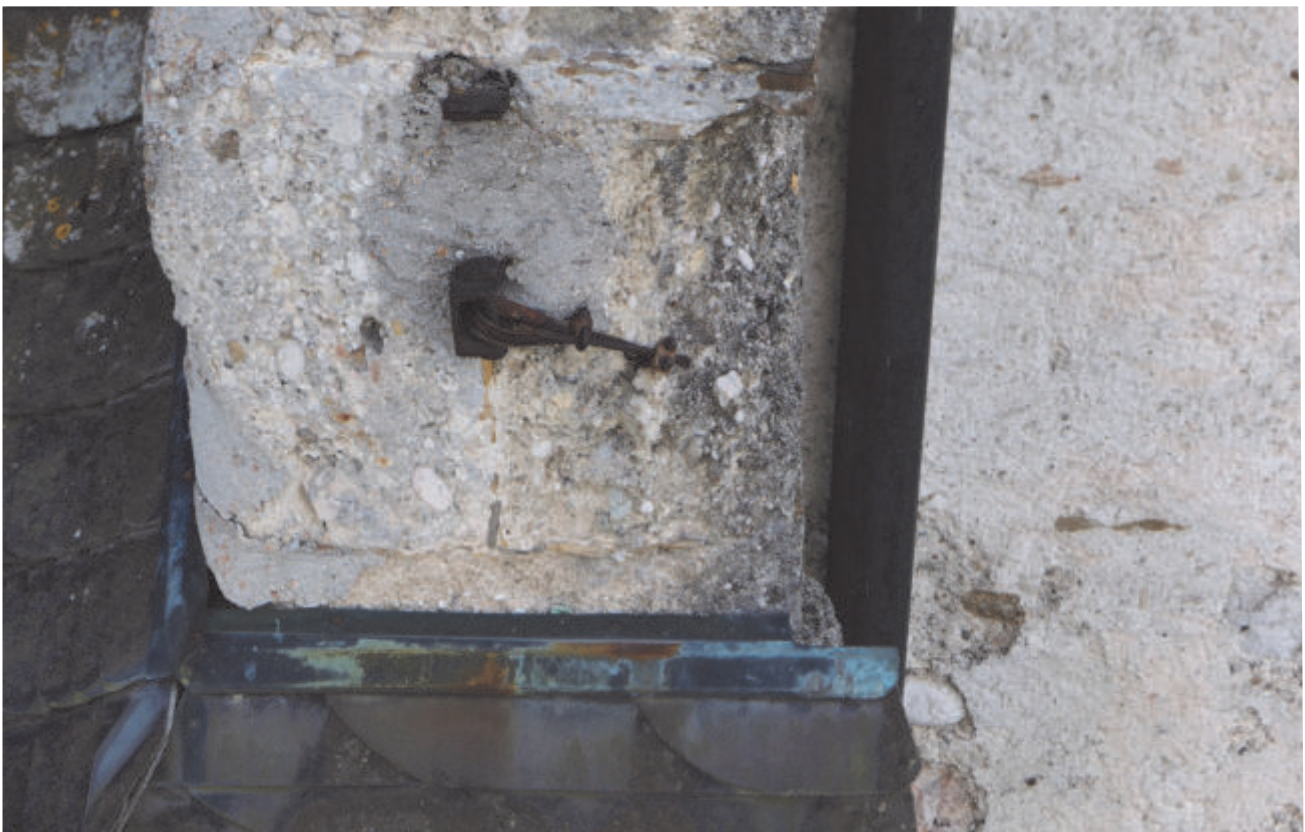
Langhaus, Nordfassade, Strebepfeiler, geschädigte Pultabschlüsse, Eisenteile
