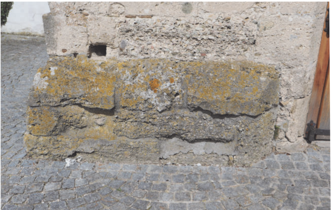
Turm, Südfassade, ausgebrochene/abgewitterte Südwestkante, reduzierte Sockelzone, biogen bewachsen
