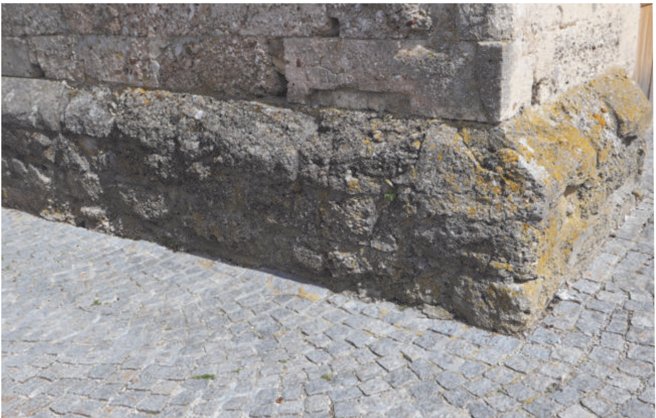
Turm, Westfassade, Verfugung mit portlandzementhaltigem Mörtel, Sockelzone biogen bewachsen, Steinoberflächen stark reduziert
