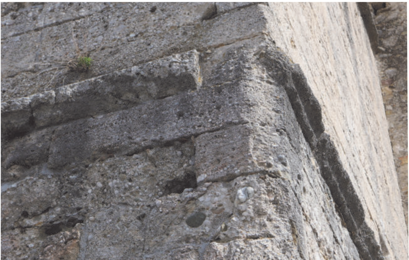
Turm, Westfassade, Traufengesims und Kaffgesims, massive Schäden
