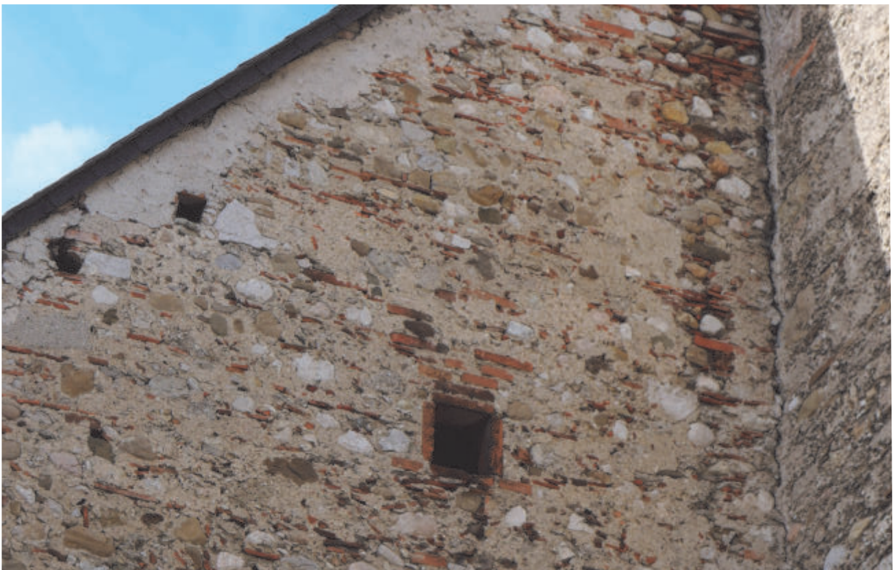
Langhaus, Südseite, Sakristei, Ostseite, moderner Eingangsbau, verputzt, Ostwand mit viel Ziegeln in der Fläche; riss im Anschluss zum Langhaus
