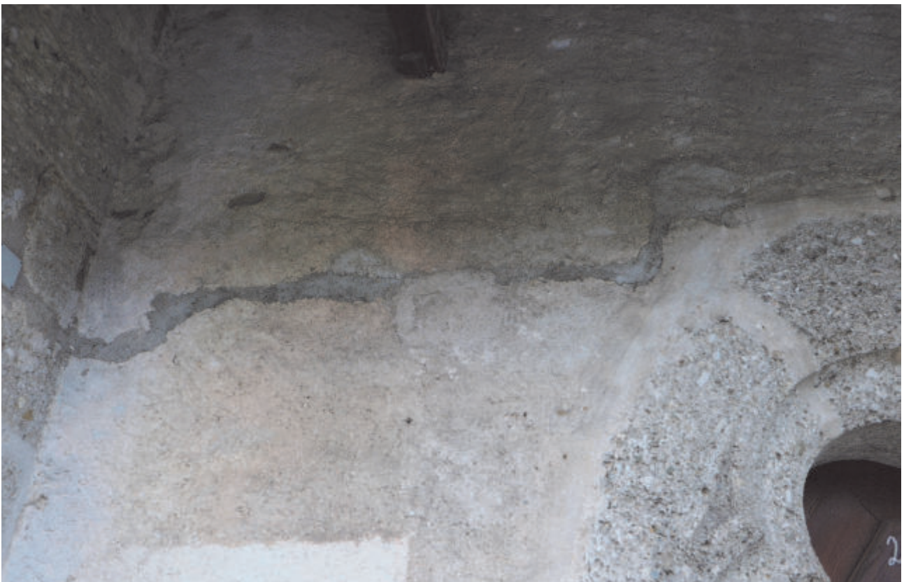
Langhaus, Nordfassade, Eingangsbereich mit Portal, Ausbesserung mit portlandzementhaltigem Mörtel (Leitungsführung)
