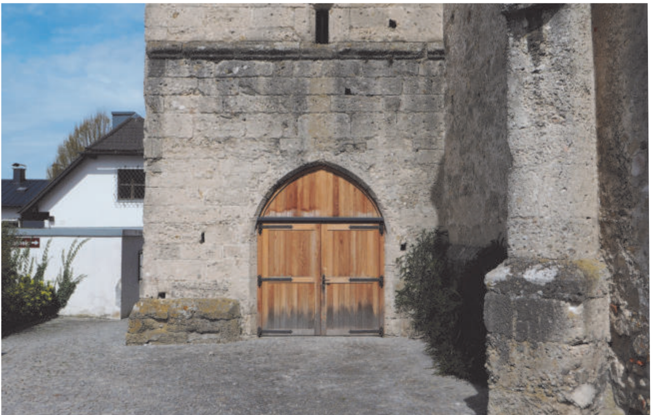
Turm, Südfassade, ausgebrochenes Kaffgesims mit Bewuchs, modernes Holzportal
