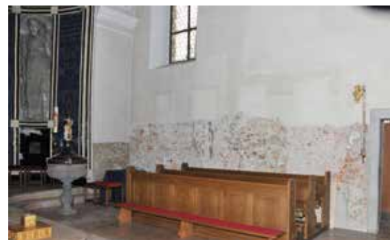
Der schadhafte Verputz wurde im November abgeschlagen
