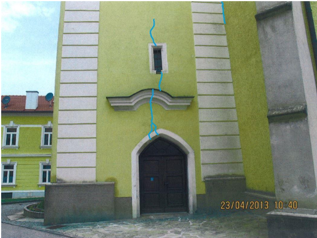
Abbildung 15: Rissmonitoring 2013 (Quelle: Befund DI Weilhartner v. 17.06.2013)
