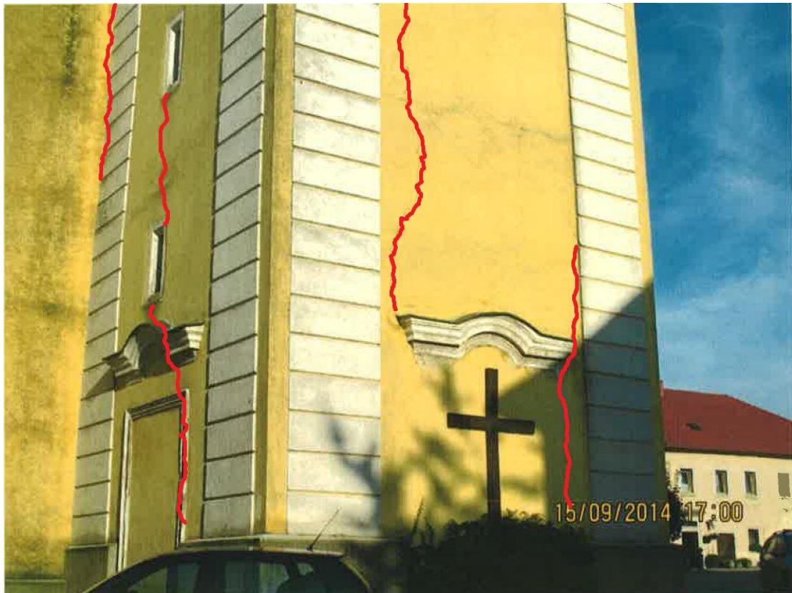
Abbildung 16: Rissmonitoring 2013 (Quelle: Befund DI Weilhartner v. 17.09.2014)
